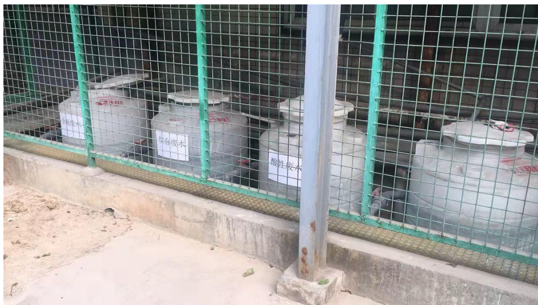
图 7.1-2 废水分类收集罐照片
