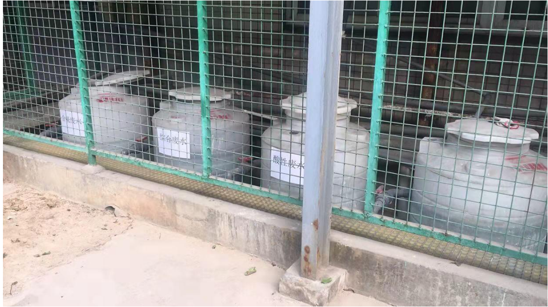
图 7.1-2 废水分类收集罐照片
